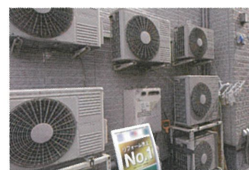
沢山のエアコン
